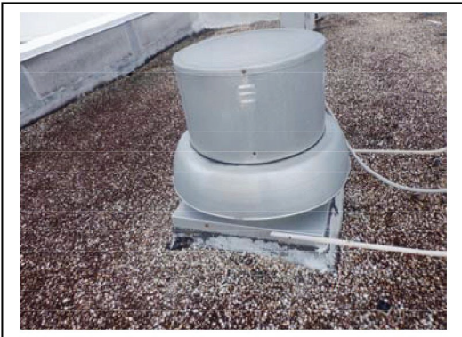
Exhaust Fan on Low Curb
